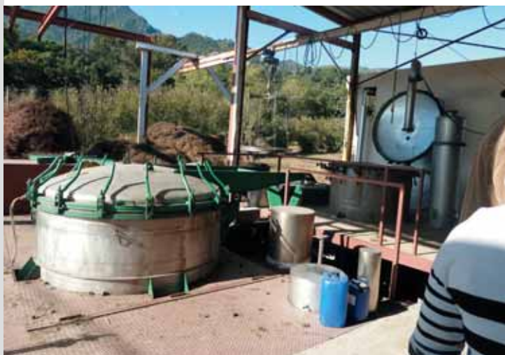
Die Tanks der Destillationsanlage
