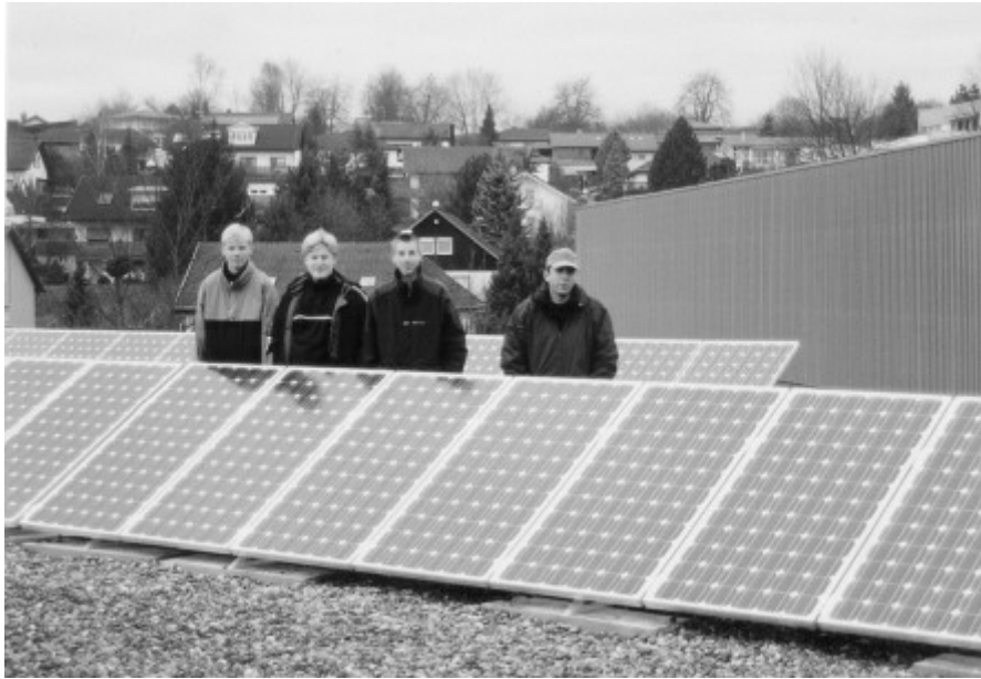
Die neue Photovoltaikanlage der heimschule St. Landolin mit Mitgliedern der Solar-AG
